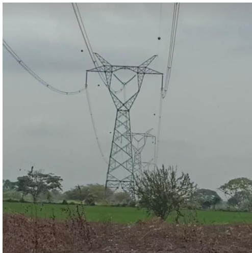
Figura 21: Torre de Alto voltaje.
