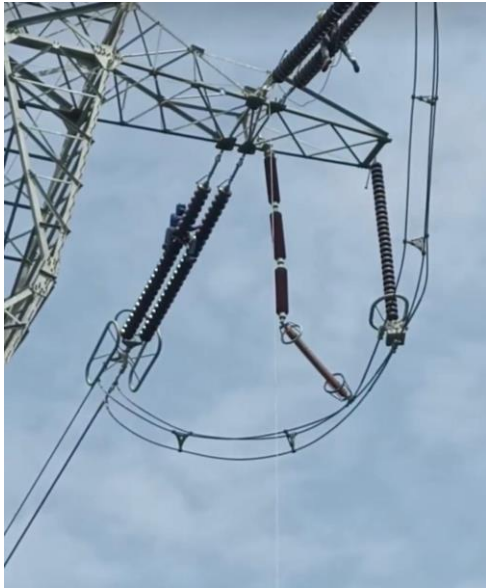
Figura 20: Aisladores de Alto voltaje.
