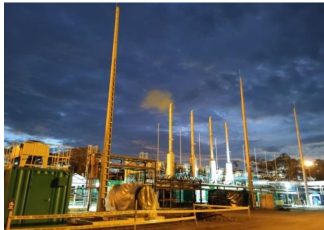
Figura 20 Central térmica de petróleo https://www.celec.gob.ec/termopichincha/wp-content/uploads/2022/04/Central_Cuyabeno_Bloque_58.jpg
