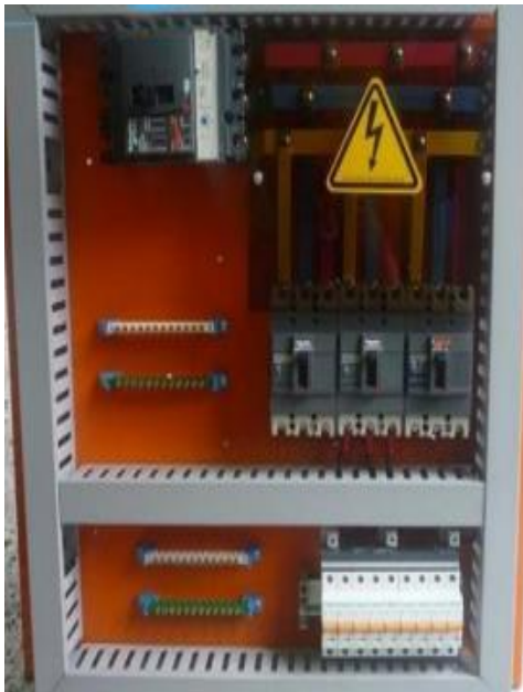
Figura 35 Tablero de distribución eléctrica
